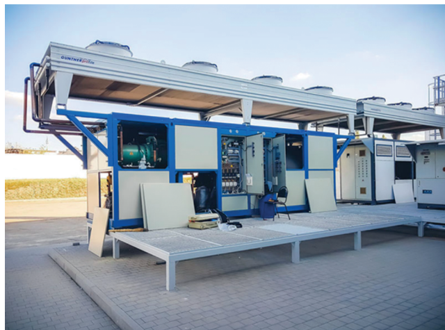
Рис. 1. Горизонтальный воздушный конденсатор фирмы ORMAT
