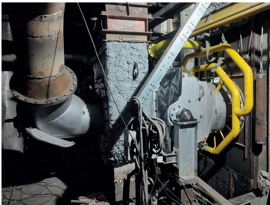
Рис. 19. Горелка, установленная на котле
