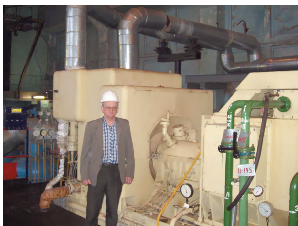
Рис. 10. Турбогенераторная установка ТГ 4 АСП12/1.2 на ТЭЦ-4 ОАО “Тверьэнерго”, г. Тверь
