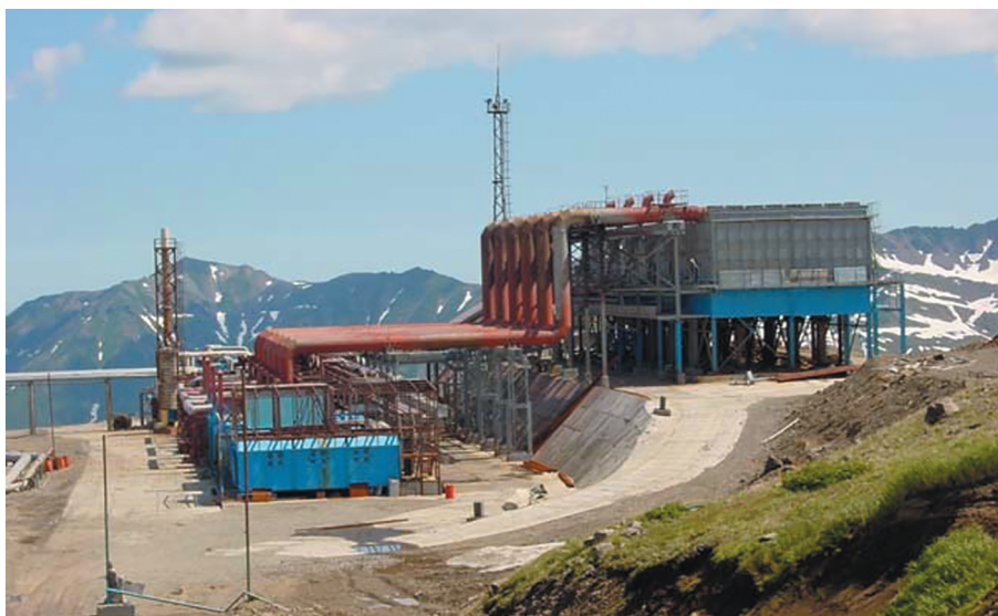
Рис. 9. Турбогенераторные установки с воздушными конденсаторами на Верхне-Мутновской ГеоЭС
