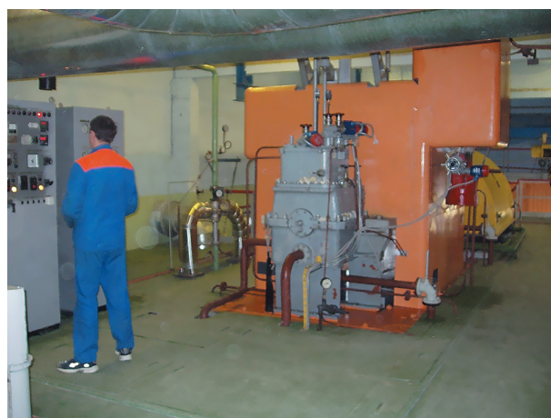
Рис. 7. Турбогенераторная установка с противодавленческой турбиной ПР-6-3.4/1.5 в котельной ЗАО “Куйбышев-азот”, г. Тольятти
