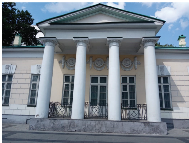
Рис. 4. Фотофиксация разрушений и трещин на главном фасаде “Дома Протковой” (начало XIX в.) и оштукатуренного исторического ограждения Филатовской больницы (Садово-Кудринская ул., 15).
