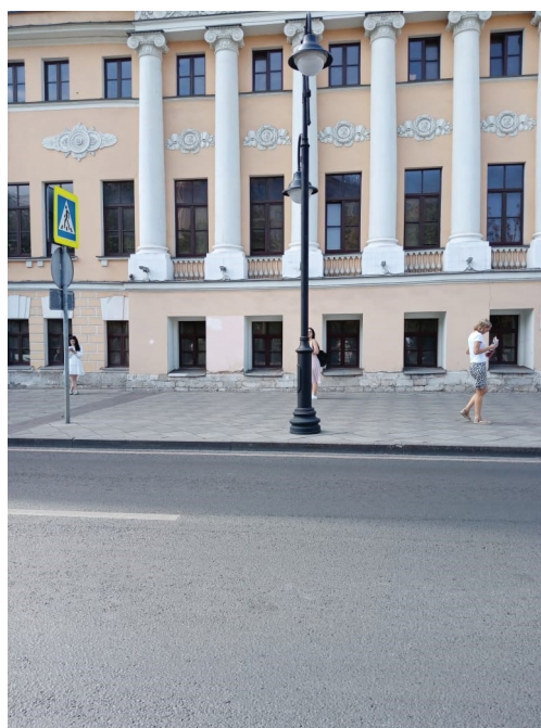
Рис. 3. Фотофиксация проблемных ситуаций, связанных с благоустройством прилегающих территорий отреставрированной Городской усадьбы конца XVIII – начала XIX вв. Водостоки, трещины на фасадах (ОКН, Пятницкая, 18).
