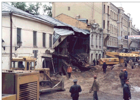
Рис. 1. Разрушение здания, вызванное провалом, образовавшимся в результате выноса водонасыщенных несвязных пород в подземную горную выработку (Москва, 1998). Фото В.П. Хоменко [14].
