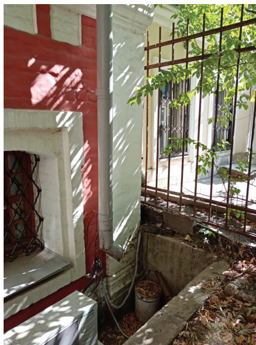
Рис. 2. Организация рельефа при реставрации Палат XVII в. и восстановлении исторических отметок главного фасада. Отмечаются нарушение водостоков, замокание стен, образование трещин на фасаде.
