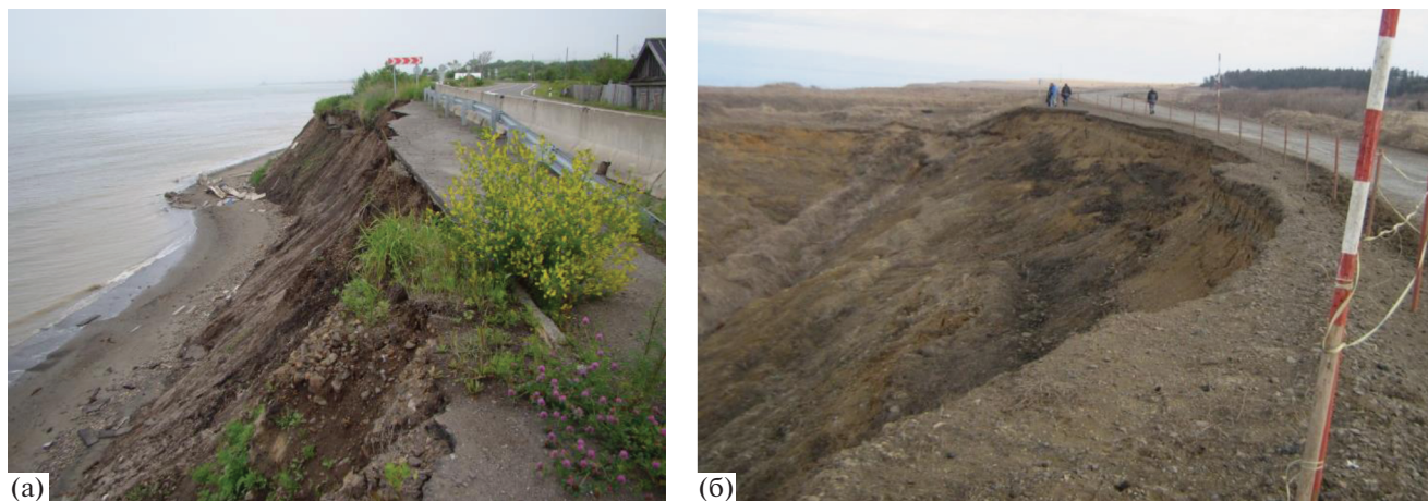
Рис. 1. Денудация земляного полотна: а — автодорога Южно-Сахалинск—Оха, 2017 г.; б — автодорога Невельск—Томари—аэропорт Шахтерский, 2007 г.
