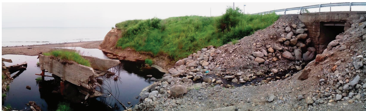
Рис. 2. Разрушение конструкций водопропускной трубы в процессе эксплуатации. Автодорога Южно-Сахалинск—Оха. Средний Сахалин, 2017 г.
