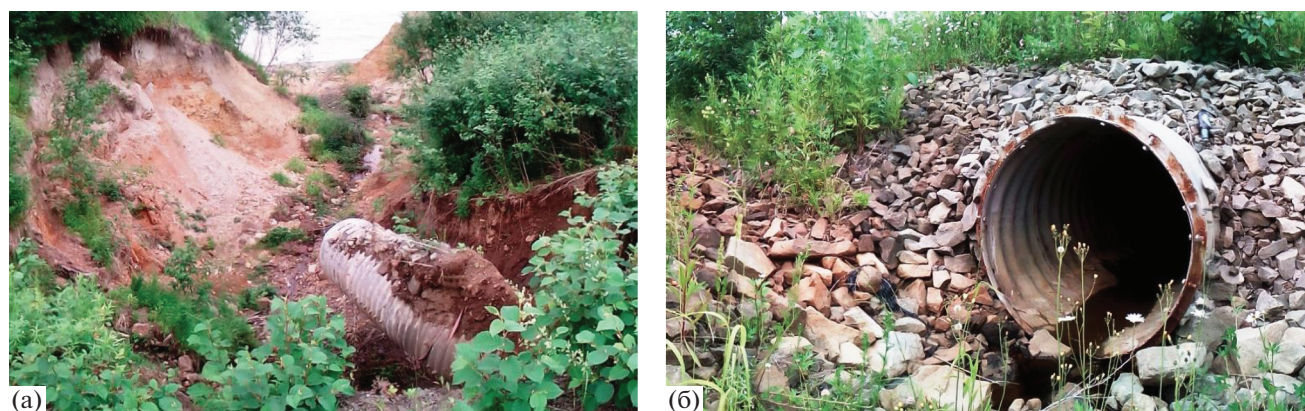
Рис. 4. Автодорога Южно-Сахалинск—Оха. Средний Сахалин, 2017 г.: а — разрушение нижнего бьефа; б — необорудованный входной оголовок.
