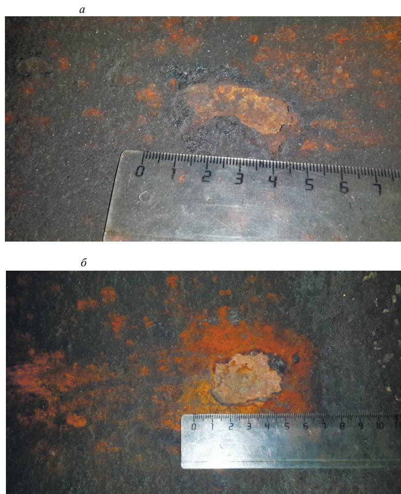
Рис. 1. Вид локальных дефектов разной формы на внутренней поверхности трубы после эксплуатации в условиях УКК.
